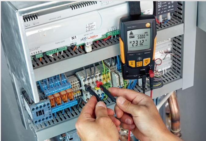
测量热泵开关盒中的电压
