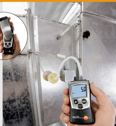
测量过滤器的差压
