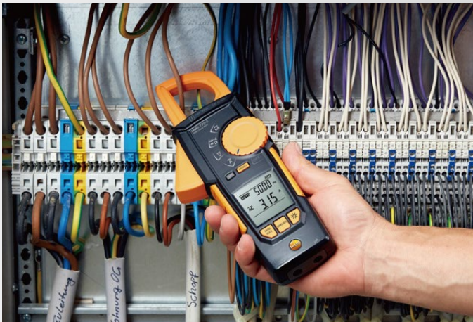
测量开关柜电流
